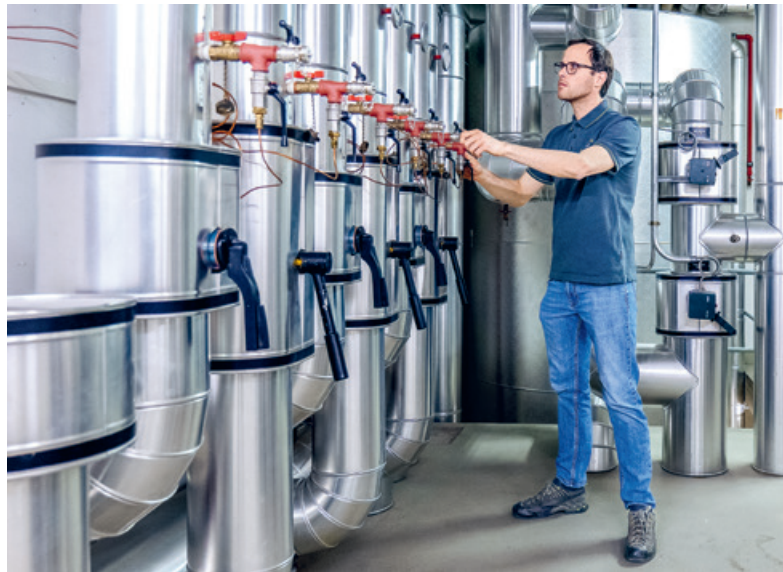
Ein Mitarbeiter der Net Zulg AG kontrolliert die Wärmeübergabestation Glockenthal.
